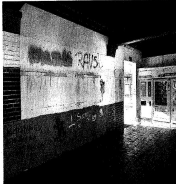
Die Winterhalle ist heruntergekommen, wenn sie saniert wird, ist derzeit nicht bekannt. Das Gebäude gehört seit 2007 einem Firmenkonsortium.
