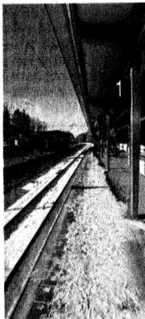
Die Dächer an den Bahnsteigen sind nicht immer dicht.
